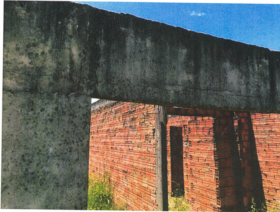
Foto 1: Obra paralisada da E.M.E.F. 8 de Dezembro.
